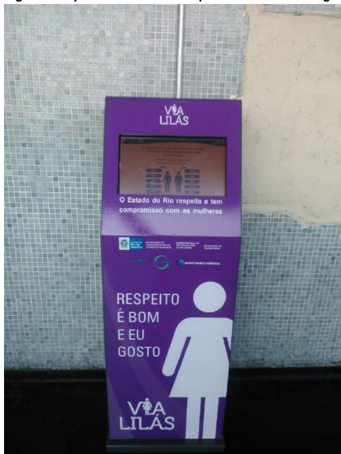
Figura 1 – Apresenta totem 2840 que foi instalado no lugar do totem 2770
